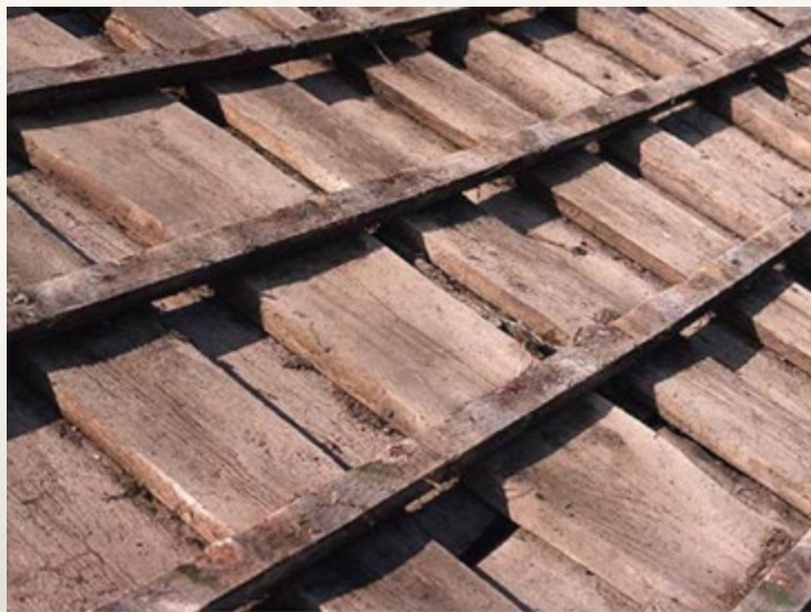
Undertak med over- og underliggere av uhevlende bord monterert i fallretningen. Foto: SINTEF Byggforsk
